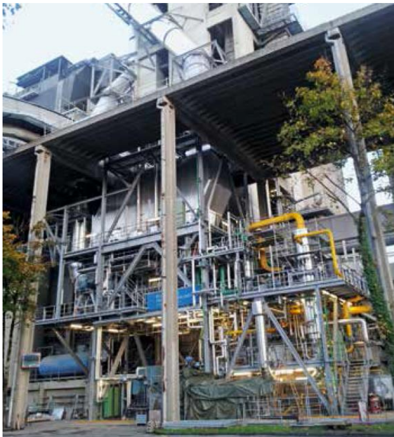
Abbildung A5.4: ORC-Energiennutzungsanlage im Zementwerk Wildegg. Quelle: Energieia 2/2014
